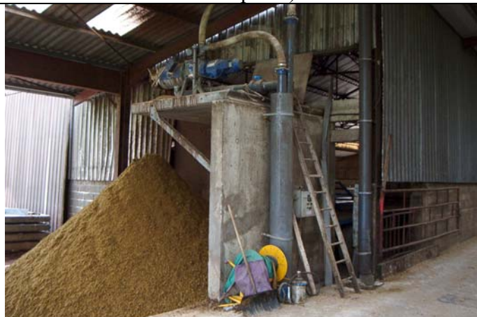
Le liquide sortant par le tuyau flexible du dessous est conduit gravitairement jusque ...
