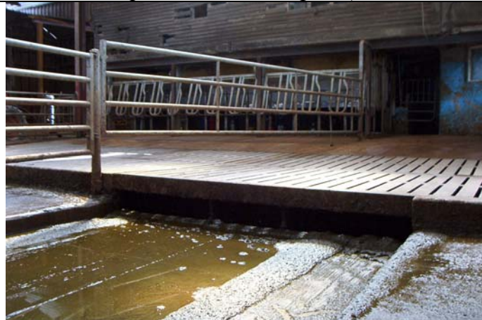
Le lisier est raclé automatiquement plusieurs fois par jour et stocké dans une fosse de 100 m3 (sous caillebotis)
