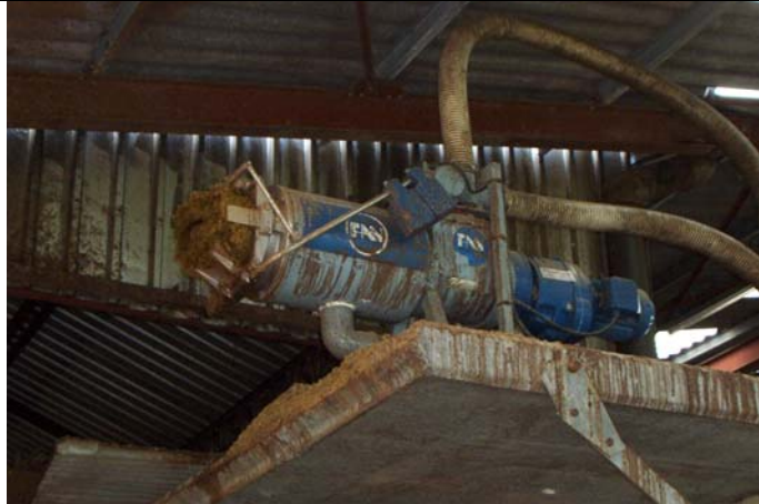
Vues du séparateur (tuyau d'alimentation au dessus alimenté par la pompe immergée dans la fosse de stockage des lisiers raclés)
