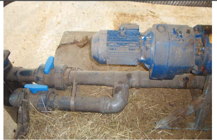
Tuyaux de retour vers la fosse de stockage
