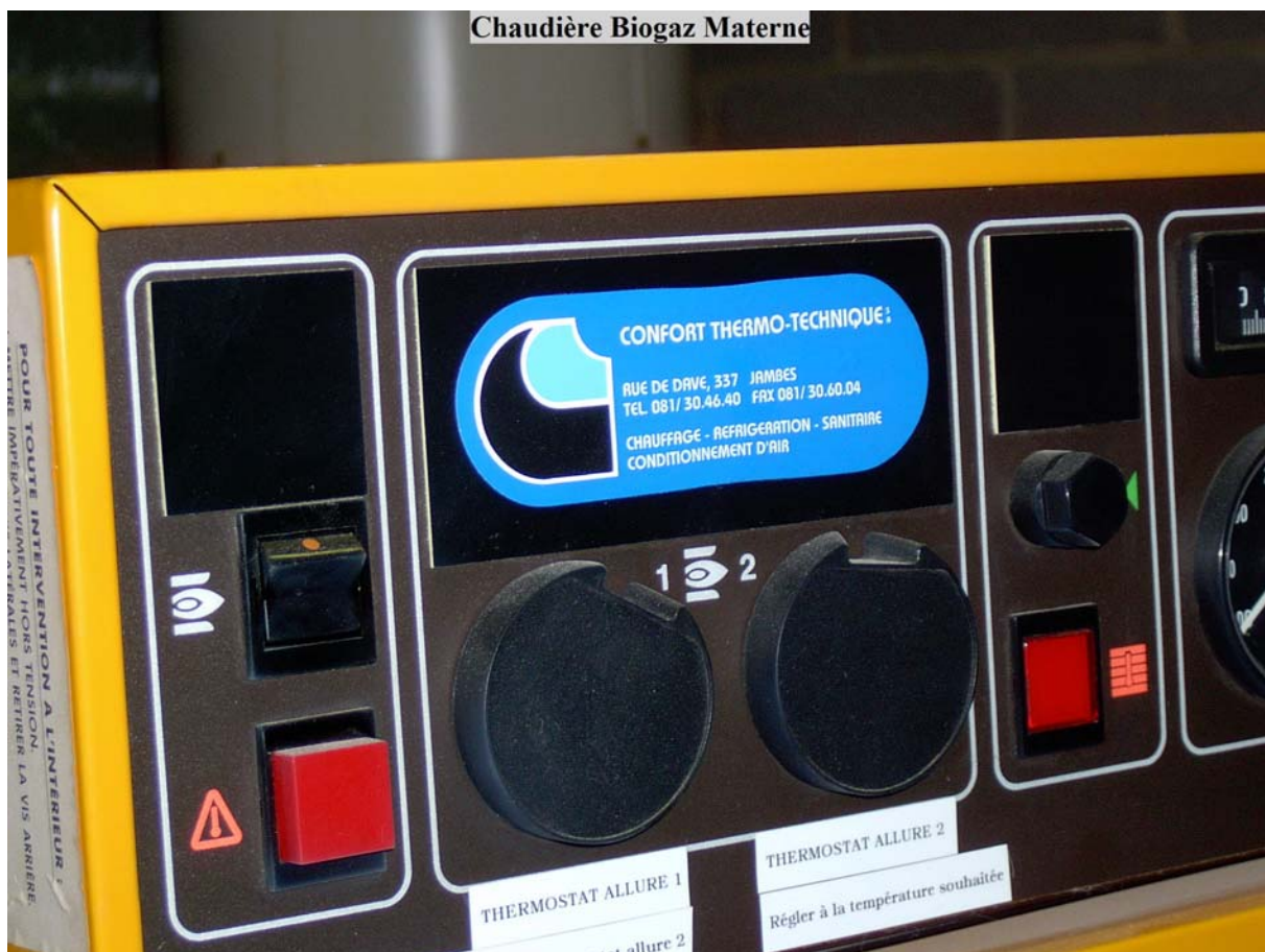
Chaudière biogaz de 409 KW
