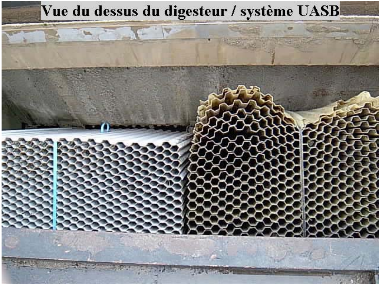
Vue du dessus du digesteur
