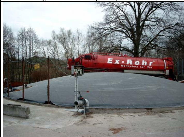
Second digesteur avec bâche et vue de la citerne de transport des lisiers fermentés
