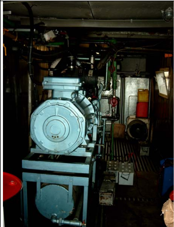
Moteur à biogaz de 75 kW él.
