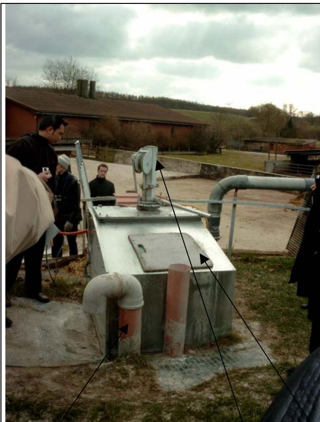
Sommet du digesteur en béton avec agitateur, fenêtre et buses plongeant dans le liquide (et par où débordent accidentellement des mousses)
