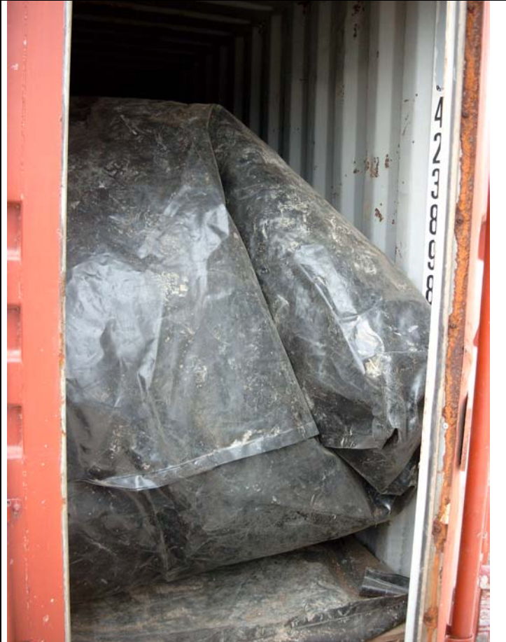
Stockage du biogaz en enveloppe PE sous container
