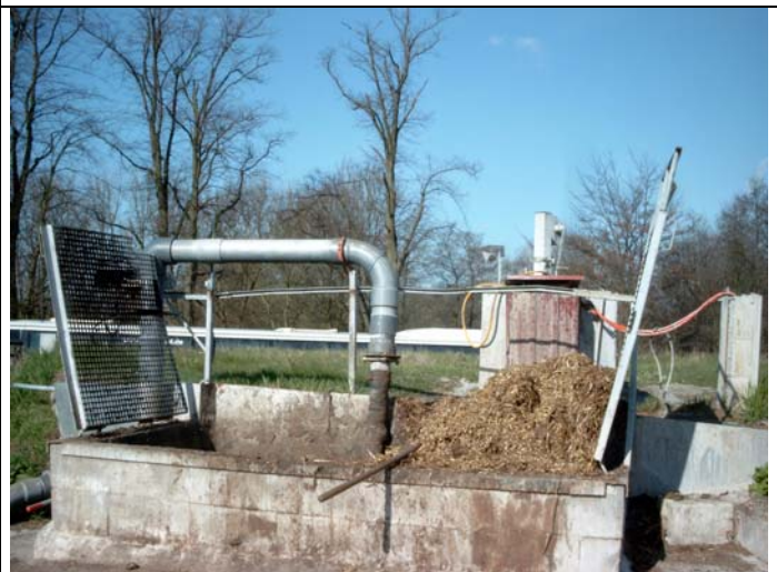
Trémie pour l'alimentation des déchets solides dans le digesteur en béton
