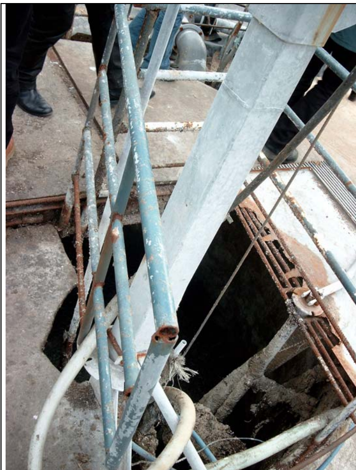
Pré-fosse pour les lisiers avant leur introduction dans le second digesteur à bâche plastique
