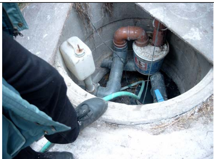
Purge d'eau sur la conduite du biogaz
