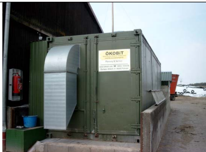
Groupe électrogène à biogaz placé dans un container insonorisé
